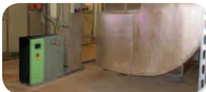
humiFog in locale di installazione
